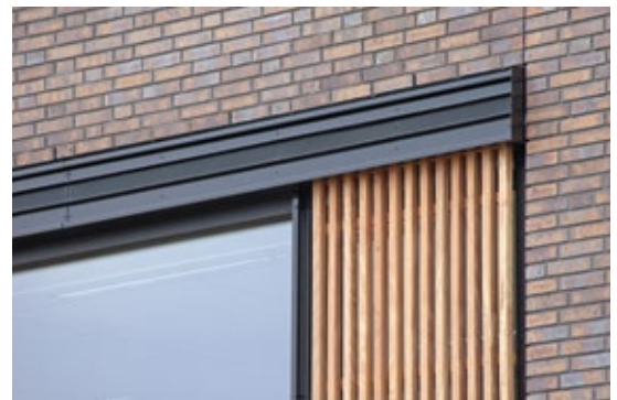
Noordwijk, Brede School Boechorst, samengesteld aluminium gevelement (ventilatieprofiel) voor een gezond binnenklimaat
